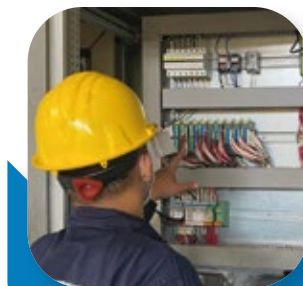
TÉCNICAS DE MANTENIMIENTO PREVENTIVO Y CORRECTIVO
